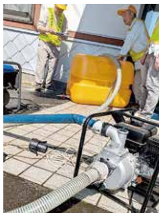
排水ポンプのエンジン点検
